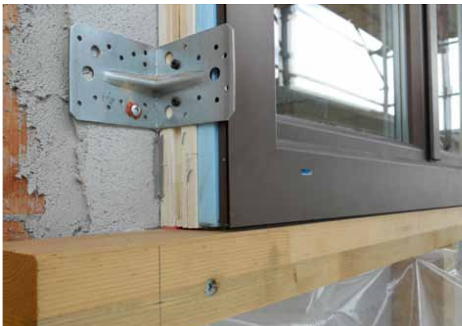
Particolare della posa del serramento sul piano del primo strato di isolante, in assenza di falso telaio.
